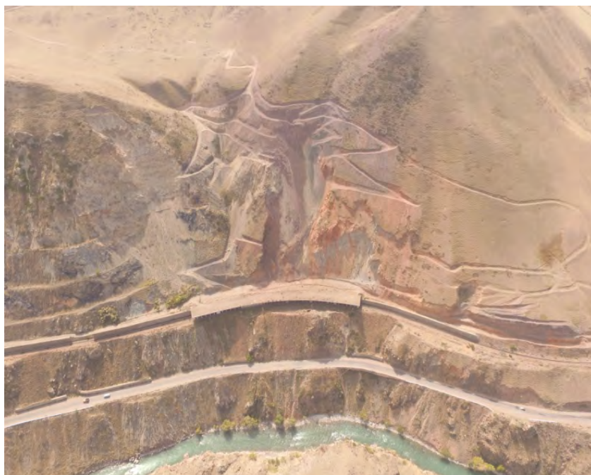
Рисунок 6 – Оползень над защитной галереей
