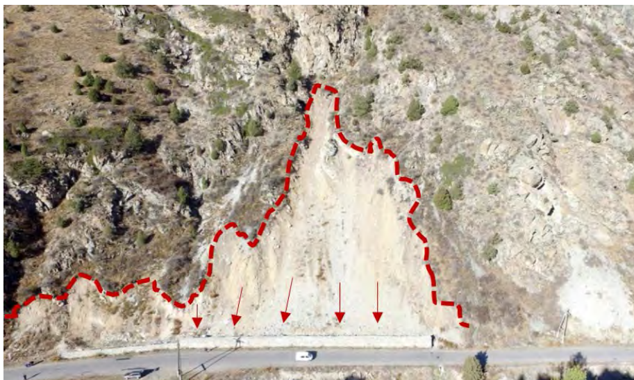
Рисунок 6 – Участок камнепадов «Ала-Арча 36 (23) км» на 23км автодороги Бишкек – Ала-Арча
