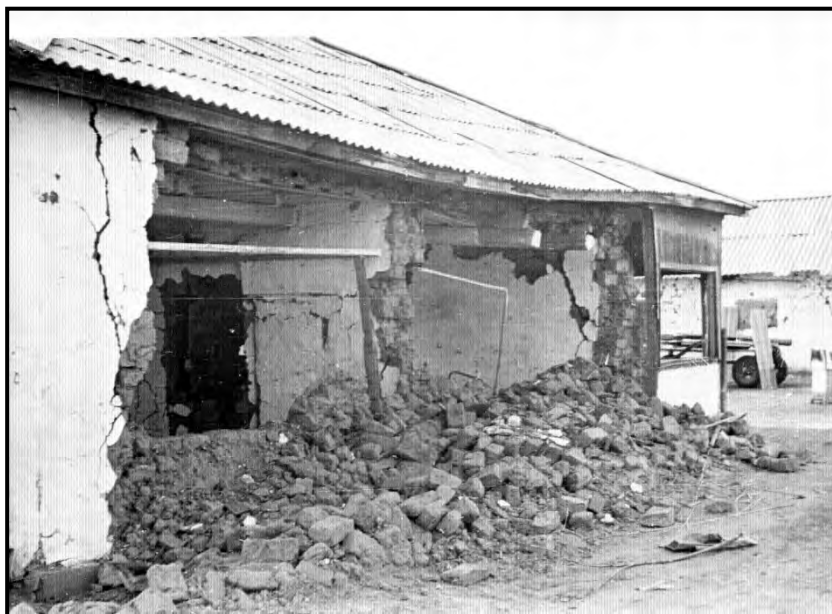
Рисунок 2 – Характерные повреждения саманной постройки при землетрясении (поселок Рожково)
